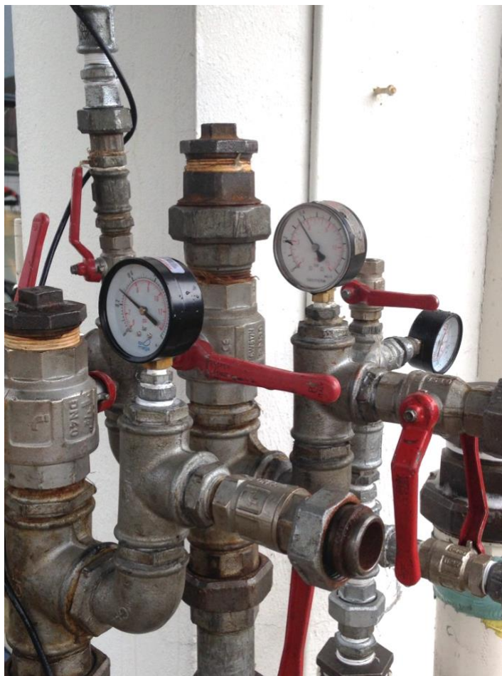
Foto 15: Op dichtheid te beproeven installatie.
